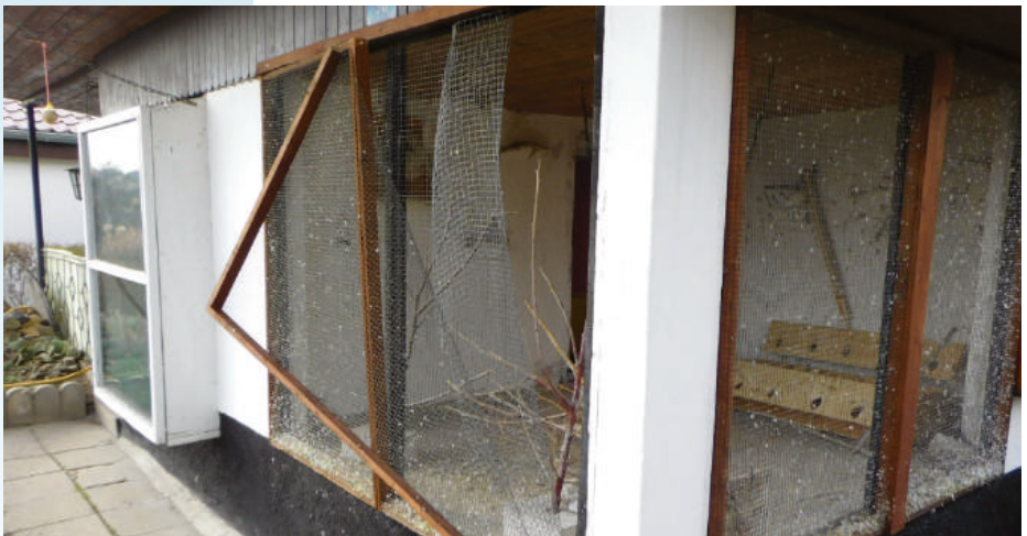
Die Voliere des Vereins wurde durch Vandalismus beschädigt.
